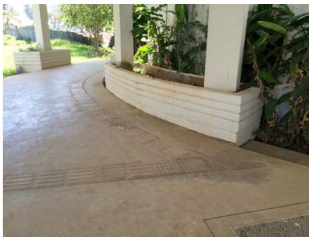
Gambar 13. Jalur pengguna difabel buta dengan arah yang tidak jelas
