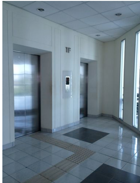
Gambar 10. Terlihat posisi dinding yang menyerong di depan lift
